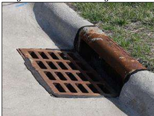
Figura 87. Boca de lobo com gradeamento
