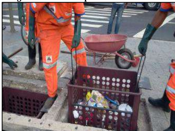
Figura 86. Cesta acoplada a boca do bueiro
