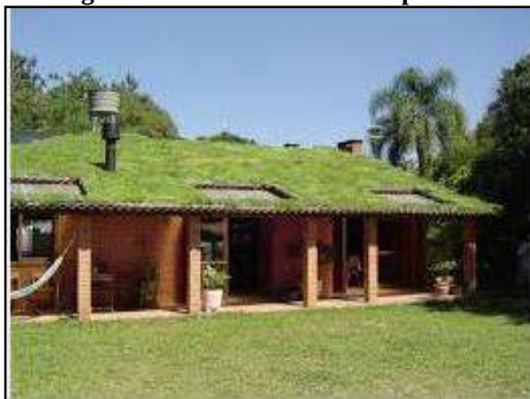
Figura 89. Telhado verde com plantas
