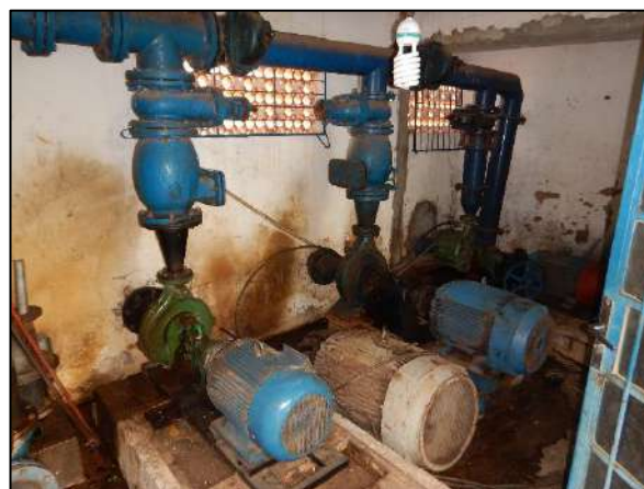
Figura 8. Casa de bombas da captação de água do córrego Gordura, em Alto Araguaia-MT
