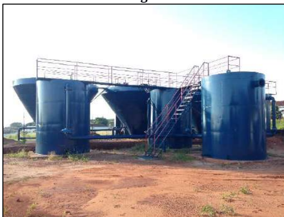
Figura 15. Vista parcial da ETA de Alto Araguaia
