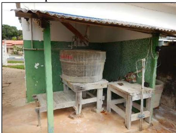
Figura 14. Vista parcial do sistema dosador de hipoclorito de cálcio na Divaes
