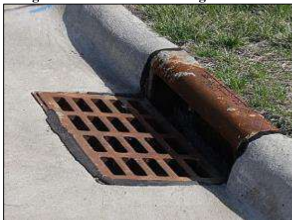
Figura 87. Boca de lobo com gradeamento
