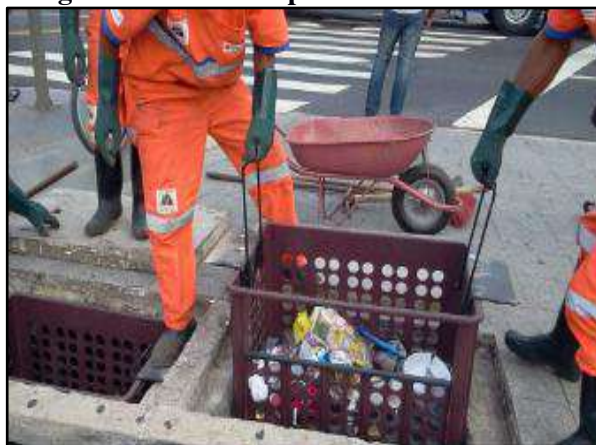
Figura 86. Cesta acoplada a boca do bueiro
