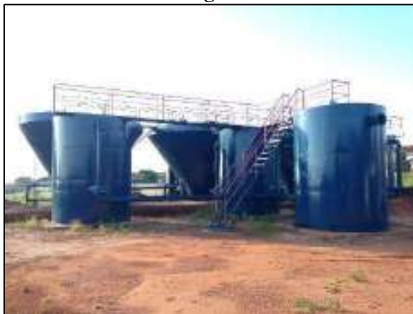
Figura 15. Vista parcial da ETA de Alto Araguaia
