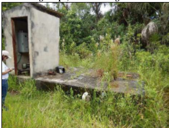
Figura 9. Vista parcial da casa de bombas no córrego Sapé, em Alto Araguaia-MT
