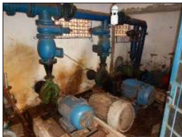
Figura 8. Casa de bombas da captação de água do córrego Gordura, em Alto Araguaia-MT
