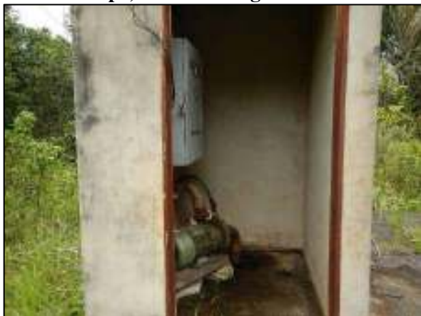
Figura 12. Vista do abrigo do painel de controle e bomba de captação do córrego Sapé, em Alto Araguaia-MT
