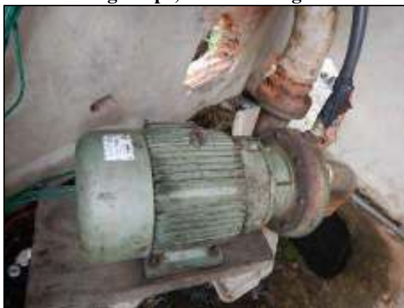
Figura 10. Bomba utilizada para captar água no córrego Sapé, em Alto Araguaia-MT
